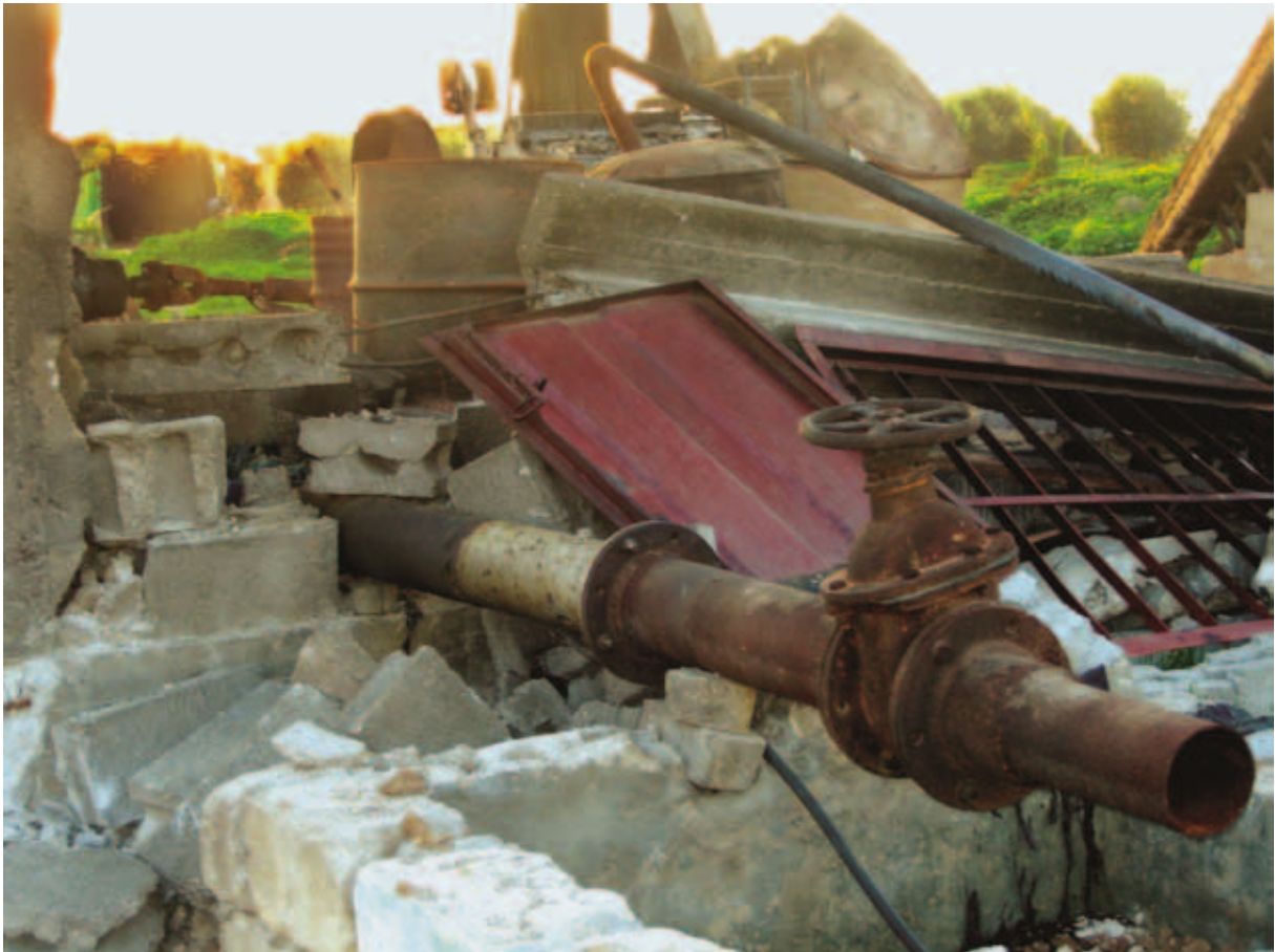
Ein Brunnen mit einer Wasserpumpe in Zaytoun, einem Vorort von Gaza-Stadt, die im Januar 2009 durch einen israelischen Angriff zerstört wurden - © AI
